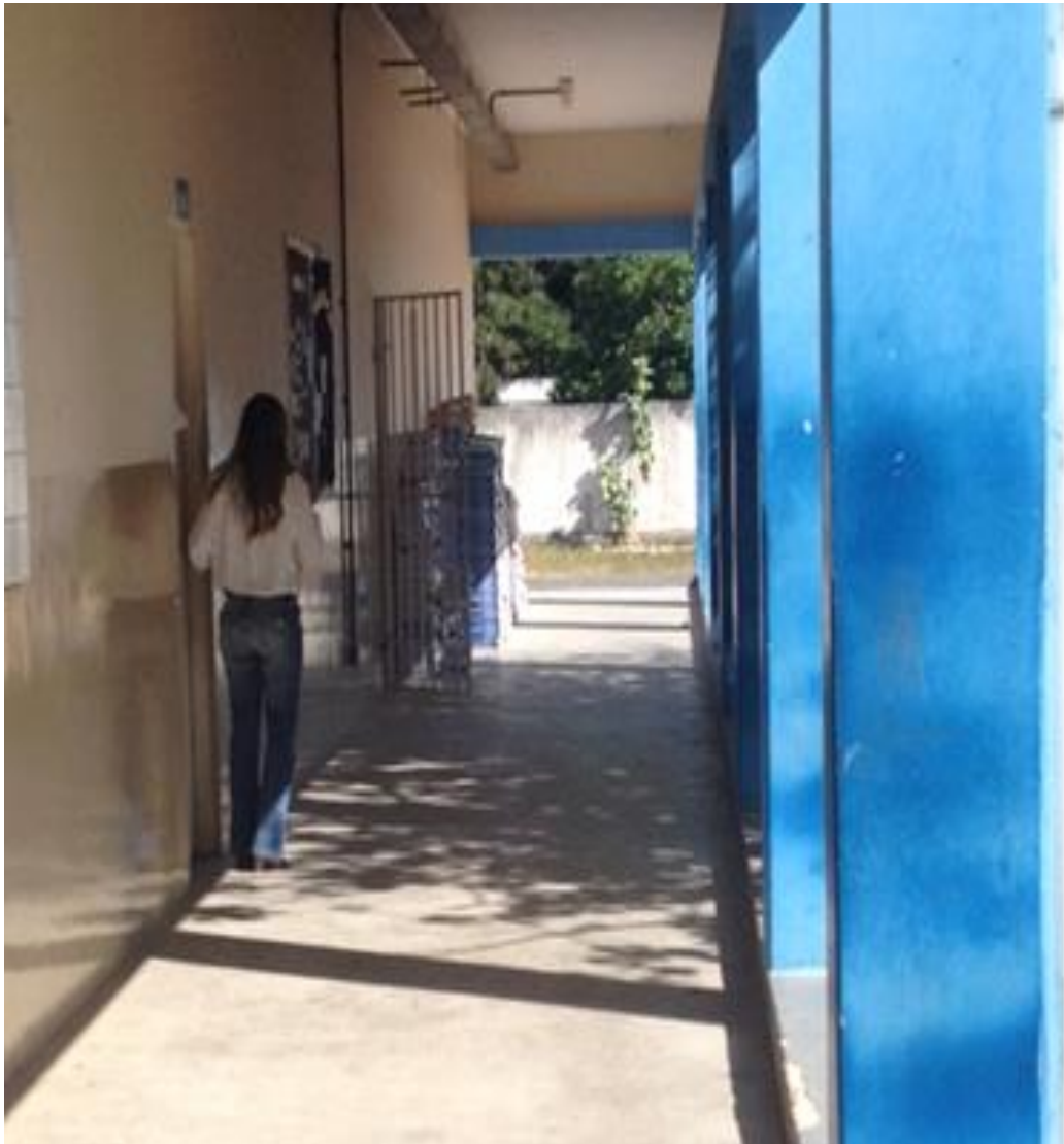
Foto 9: Armazenamento indevido de livros didáticos novos, expostos ao sol e chuva. EMEF – Dr. Mário Vello Silveiras. Conceição da Barra/ES, agosto/2016. Fonte: arquivo próprio
