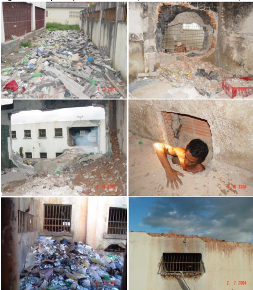
Figura 3 – Depredação da CASCUVI (Casa de Custódia de Viana)
