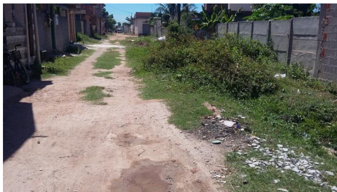
Foto 10 - Valetas cobertas pelo mato em decorrência das Fotos 8 e 9
