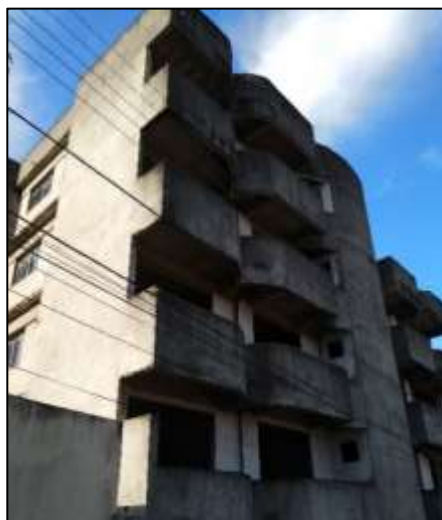
Figura 15 - Edificação não finalizada e lote de residência abandonada
