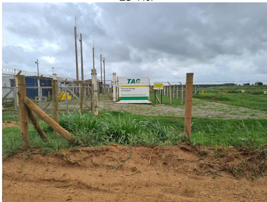
Figura 5. Ponto de Entrega de Gás de Linhares (Petrobras) localizado na Rodovia ES-440.
