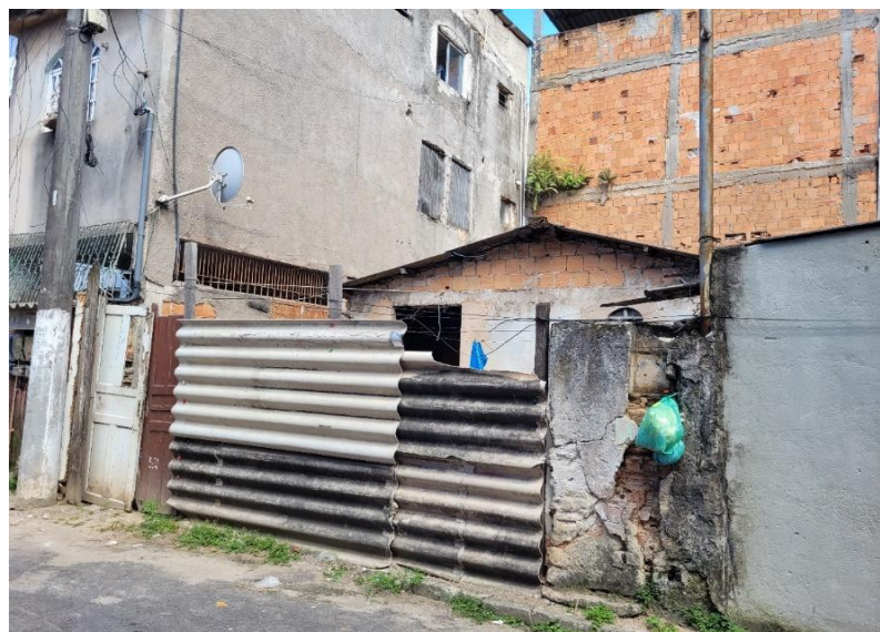
Figura 24. Muro improvisado com telha de Eternit
