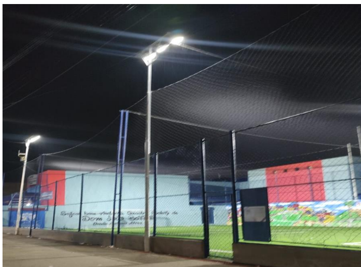
Figura 18: Iluminação da Quadra Fonte: Autor, 2022.
