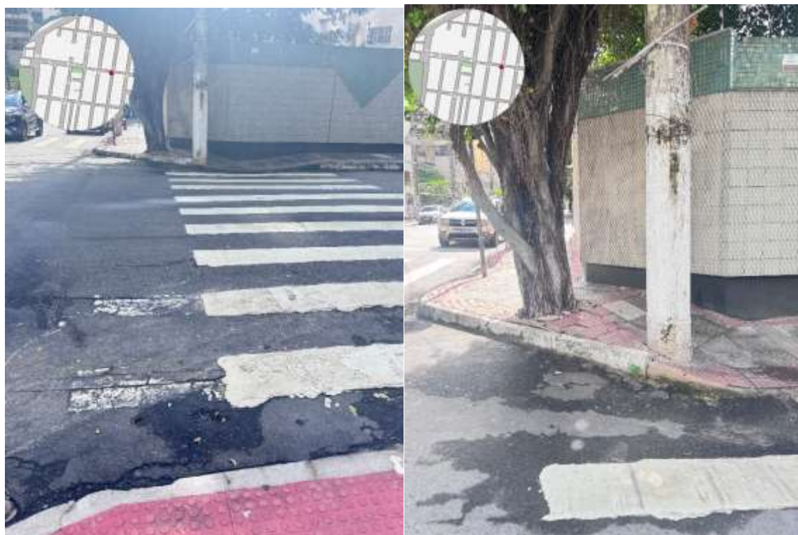
Figura 55: Problemas encontrados nas travessias
