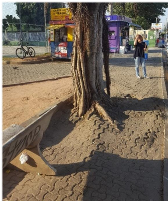
Figura 43 - Trecho de calçada próximo à Praça central do bairro
